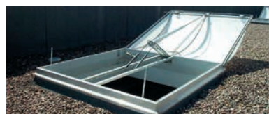
VARIO Lichtklappe mit RWA-Beschlag und E-Motoren nach RWA-Auslösung in Endlagenstellung
