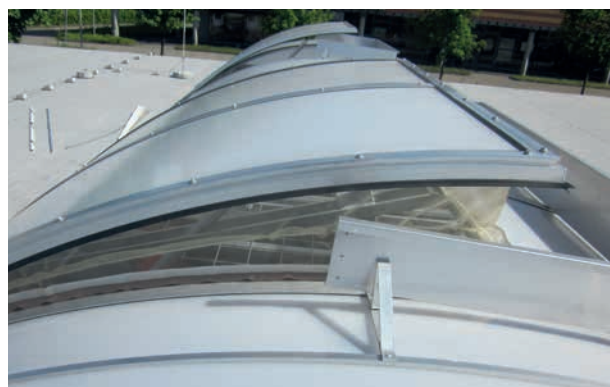
Lichtbandklappe in Lüftungsstellung mit Insektenschutzsystem
